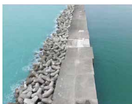
防波堤のずれ（高度約30m）
