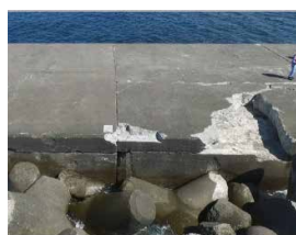
上部工の欠損（高度約10m）
