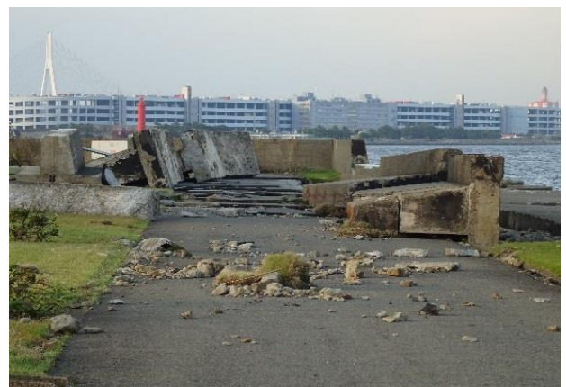
図-1.4 本牧D突堤の護岸パラペットの倒壊状況
