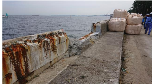
図-1.2 福浦地区護岸パラペットの倒壊状況
