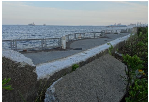
図-1.3 本牧D突堤の護岸パラペットの破損状況
